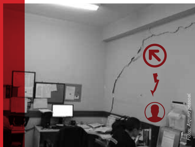
Na unidade de Rio Claro, goteiras danificaram documentos; embaixo, rachadura na unidade de Guarulhos.
